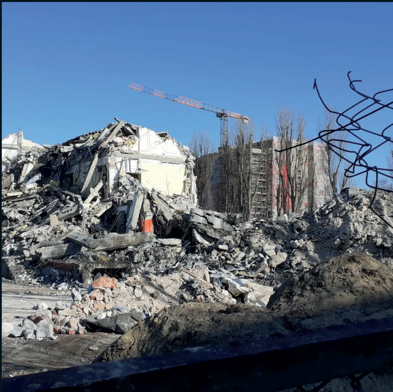
Gdańsk, Przymorze Wielkie, ul. Jagiellońska. Na pierwszym planie budynek w rozbiórce, na drugim – budynek w budowie. Marzec 2022 roku. Fot. Anita Badyniak.
